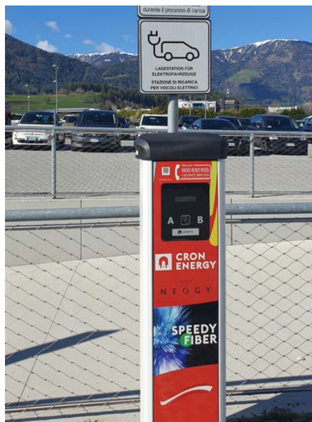
Eine der geplanten Ladesäulen
